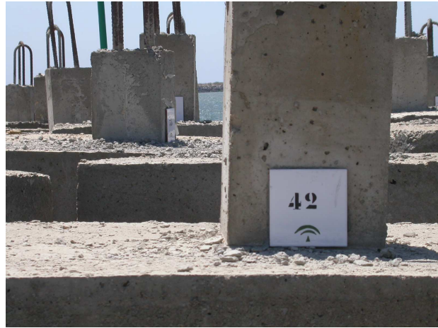
Imagen nº4. Detalle placa cerámica identificación mal colocada.
